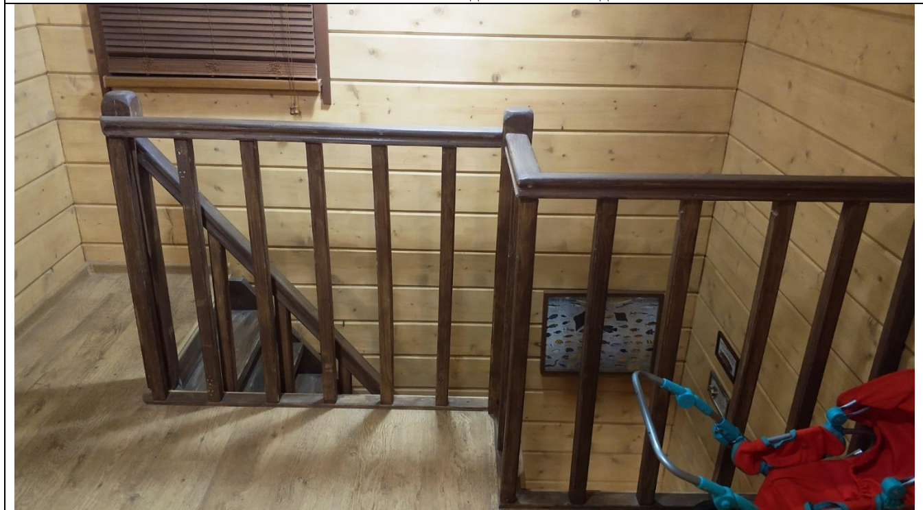
Фото 32. Состояние отделки гостевого дома
