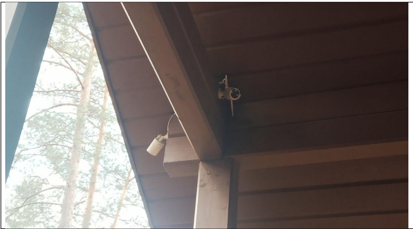
Фото 39. Состояние отделки жилого дома, видеонаблюдение
