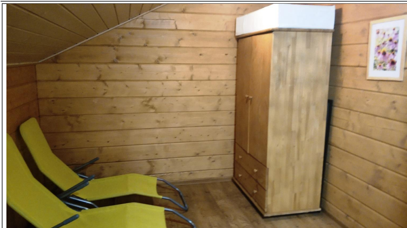
Фото 29. Состояние отделки гостевого дома
