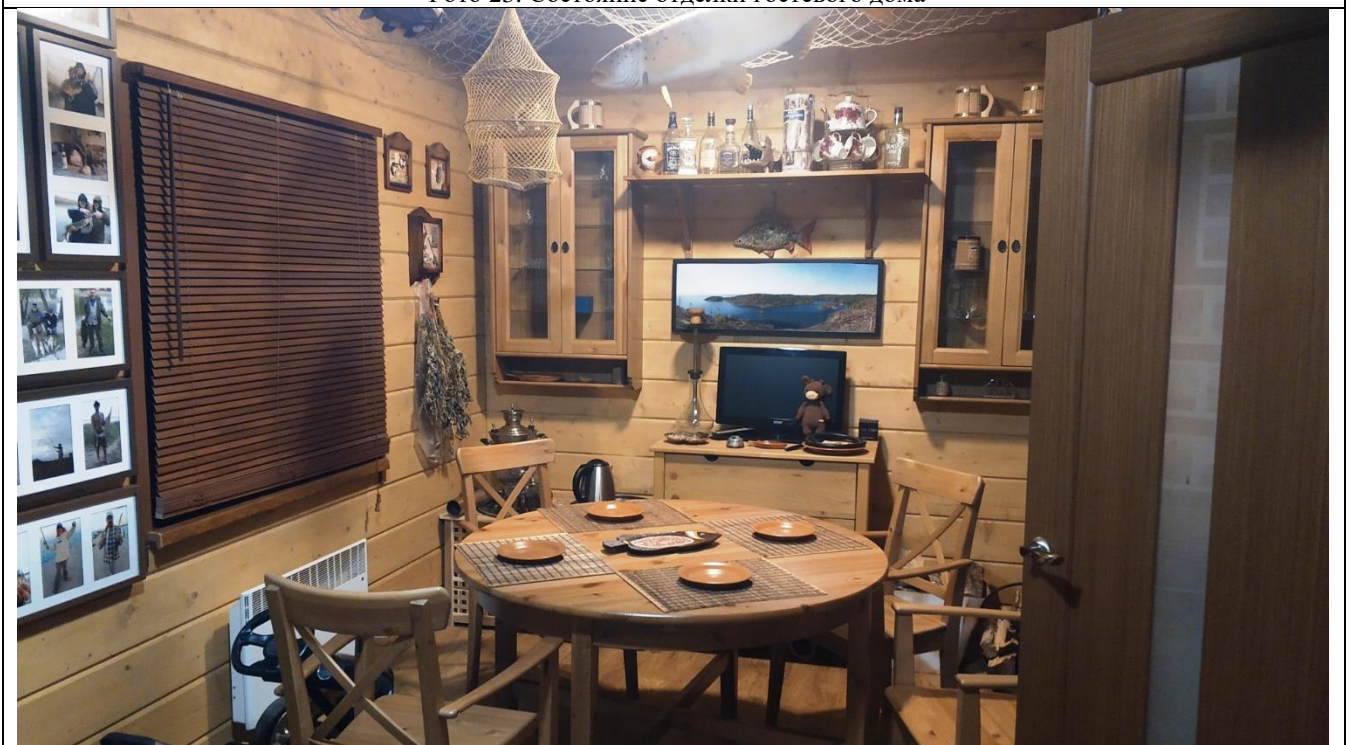
Фото 24. Состояние отделки гостевого дома
