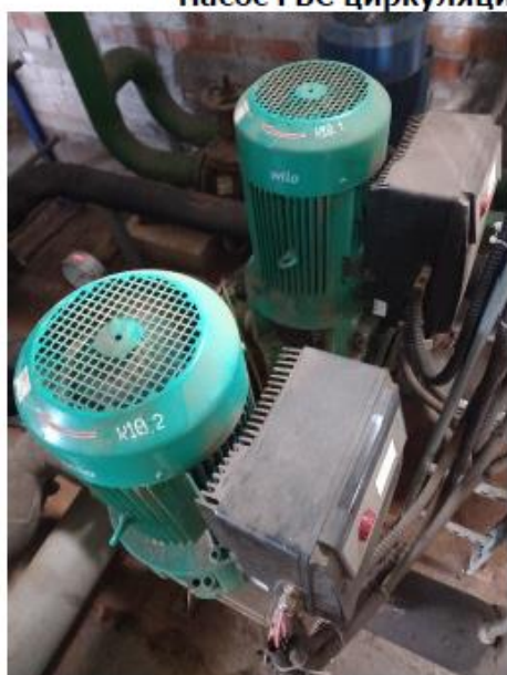
Насос ГВС циркуляционный «Wilo» (IL E 40/200-7.5/2-R1)
