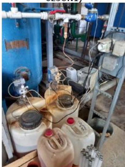
Система химводоподготовки (Hidrotech DS 6E50N1)
