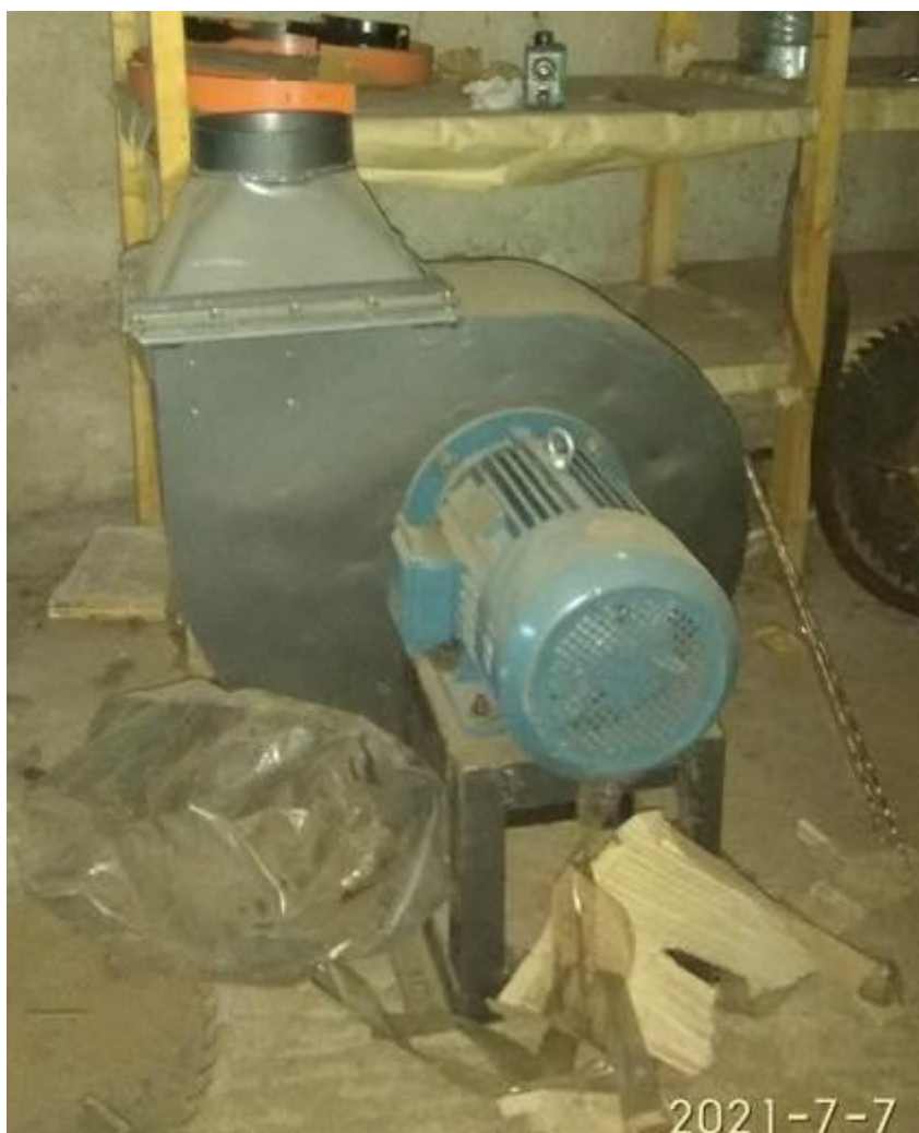
Центробежный вентилятор в сборе с улиткой и диффузором для удаления древесных опилок. (инв. № 28)
