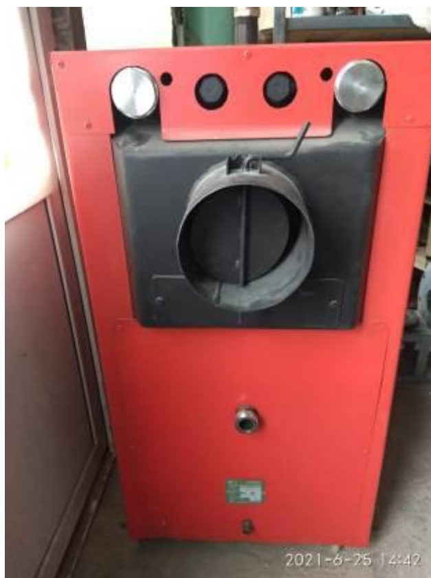
Котёл отопления красного цвета (твердотопливный) б/у, Инв. № 32_11
