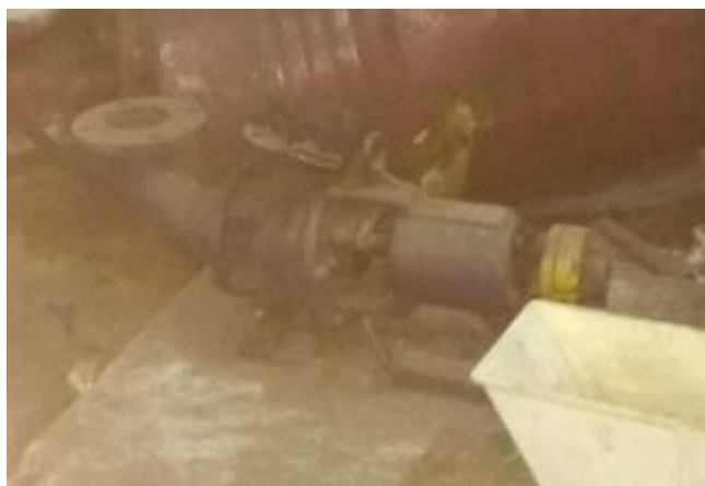
Водяной насос для отопления (без электрического двигателя, б/у) Инв. №№ 31_3, 31_4
