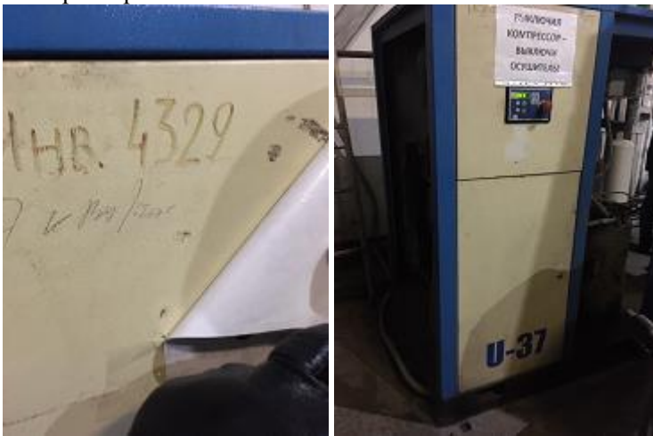
Компрессорная установка U-37/10, инв. № 4329
